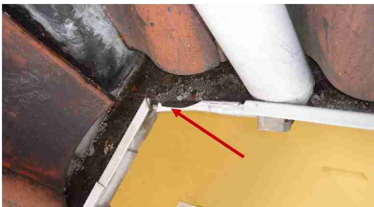
Tagrenden i hjørnet af Aldersrogade og Valkyriengade er beskadiget Og regnvand løber ned af facaden. Tagrenden bør udskiftes. Anslået pris ekskl. Lift kr. 1.000,- ekskl. Moms. Bør udføres inden for en tidsramme af 1 år.
