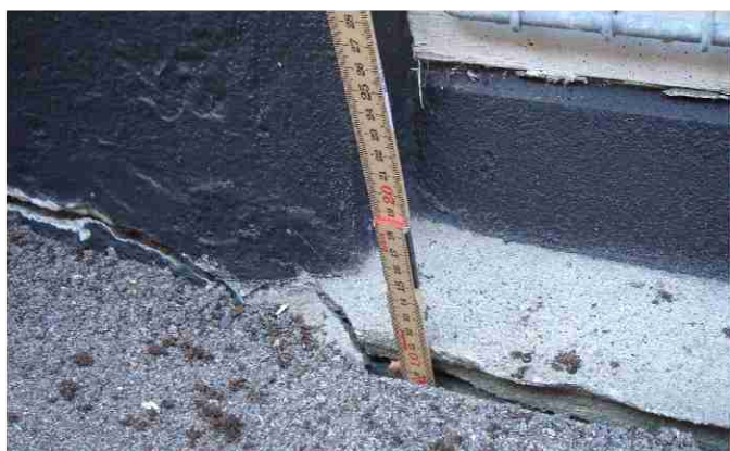
Skade ved kældervindue mellem bagtrappe Valkyriengade 17 & 19.
