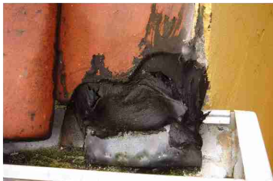
I hjørnet af Aldersrogade og Slangerupgade på manzarddelen mangler et hjørne af en tagsten. Der er repareret med tagtjære, stenen bør skiftes ved lejlighed
