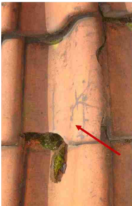
Slangerupgade 32 Beskadigede sten
