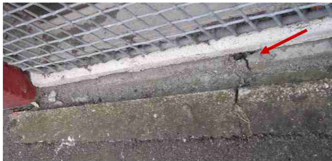
Revnet betonsålbænk ved Valkyriengade 29, gadeside
