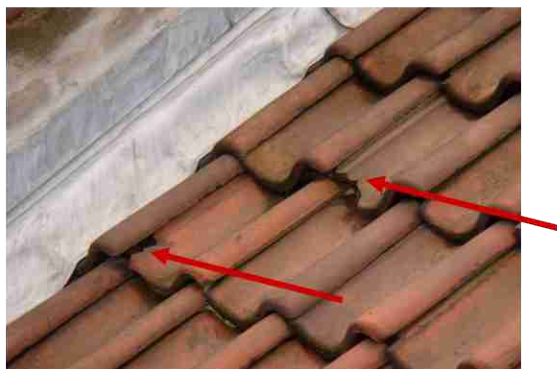
Ved Valkyriengade 17, ved tagindækning
