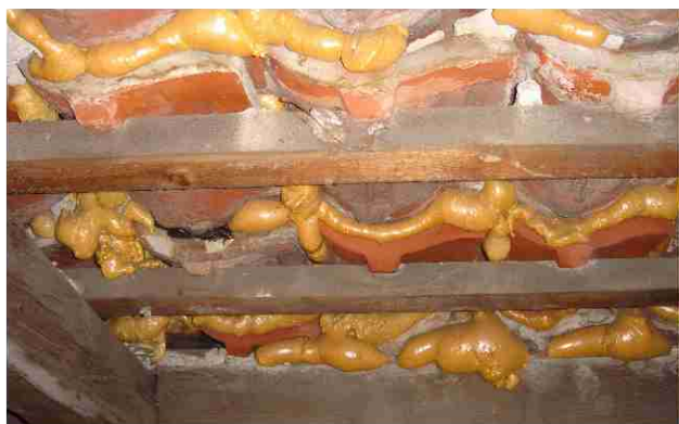
Fugeskum set indefra tagrummet.
