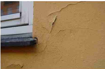
Skade ved bagtrappe Valkyriengade 19.
