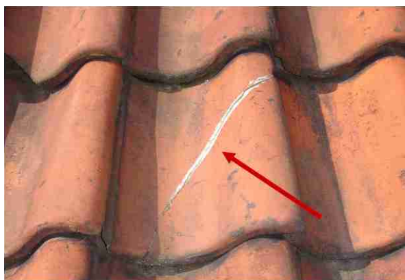
Slangerupgade 26-28 Beskadigede sten
