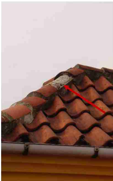
Valkyriengade 29 trappehus Der er røget en tagsten af rygningen Tagstenen har smadret en tagsten På underliggende tag. En ny sten bør opsættes og rygningen Gennemgås for løse sten. Anslået pris ekskl. Lift kr. 1.500,- ekskl. Moms. Bør udføres inden for en tidsramme af 1 år.
