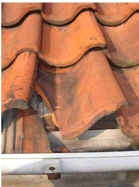
Valkyriengade 17 ved brandkam. Beskadiget sten
